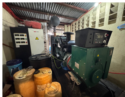
発電機・浄水室完備
